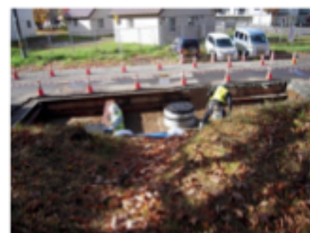
写真3 マンホールを埋めていた
